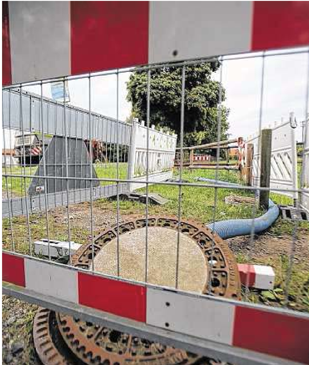
Die Druckrohrleitung von Seehäuser zum Wiesendamm ist beschädigt und wurde vom Netz genommen. Vorübergehend wird eine offene Leitung „im Freigefälle“ genutzt. FOTO: HASSELBERG
