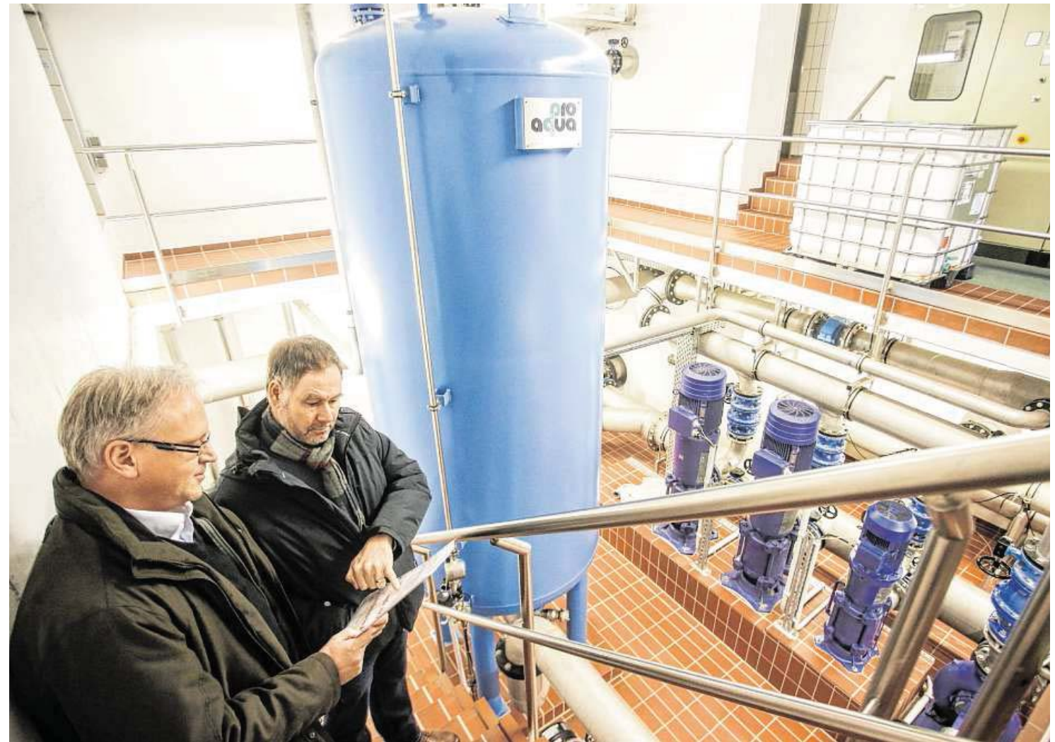
WAV-Geschäftsführer Arno Seebeck (rechts) und Michael Hein, Assistent der Geschäftsleitung, auf Stippvisite im Wasserwerk Ritterhude. Zum 1. Januar ist die Anlage in den Besitz des Wasser- und Abwasserverbandes übergegangen.
