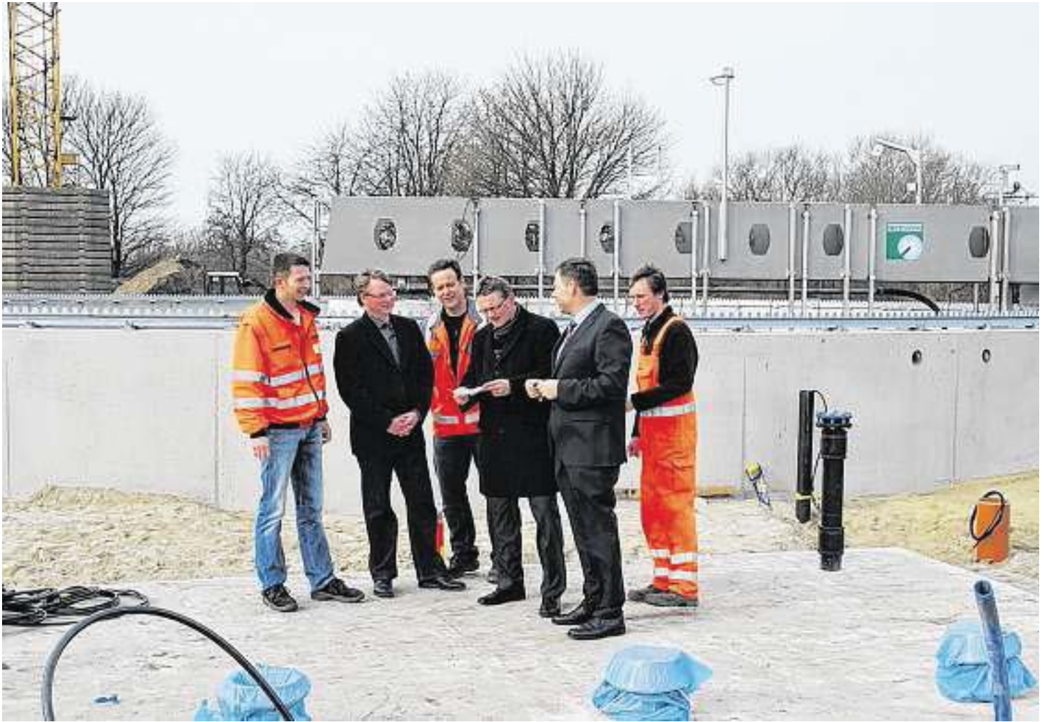
Stellten den Baufortschritt am Grasberger Klärwerk gestern vor (von rechts): Marcel Fritz, Arno Seebeck, Bernd Lütjen, Hartmut Schnakenberg, Stefan Giese und Torsten Schröder vom Wasser- und Abwasserverband Osterholz. FOTO: KLAUS GÖCKERITZ
