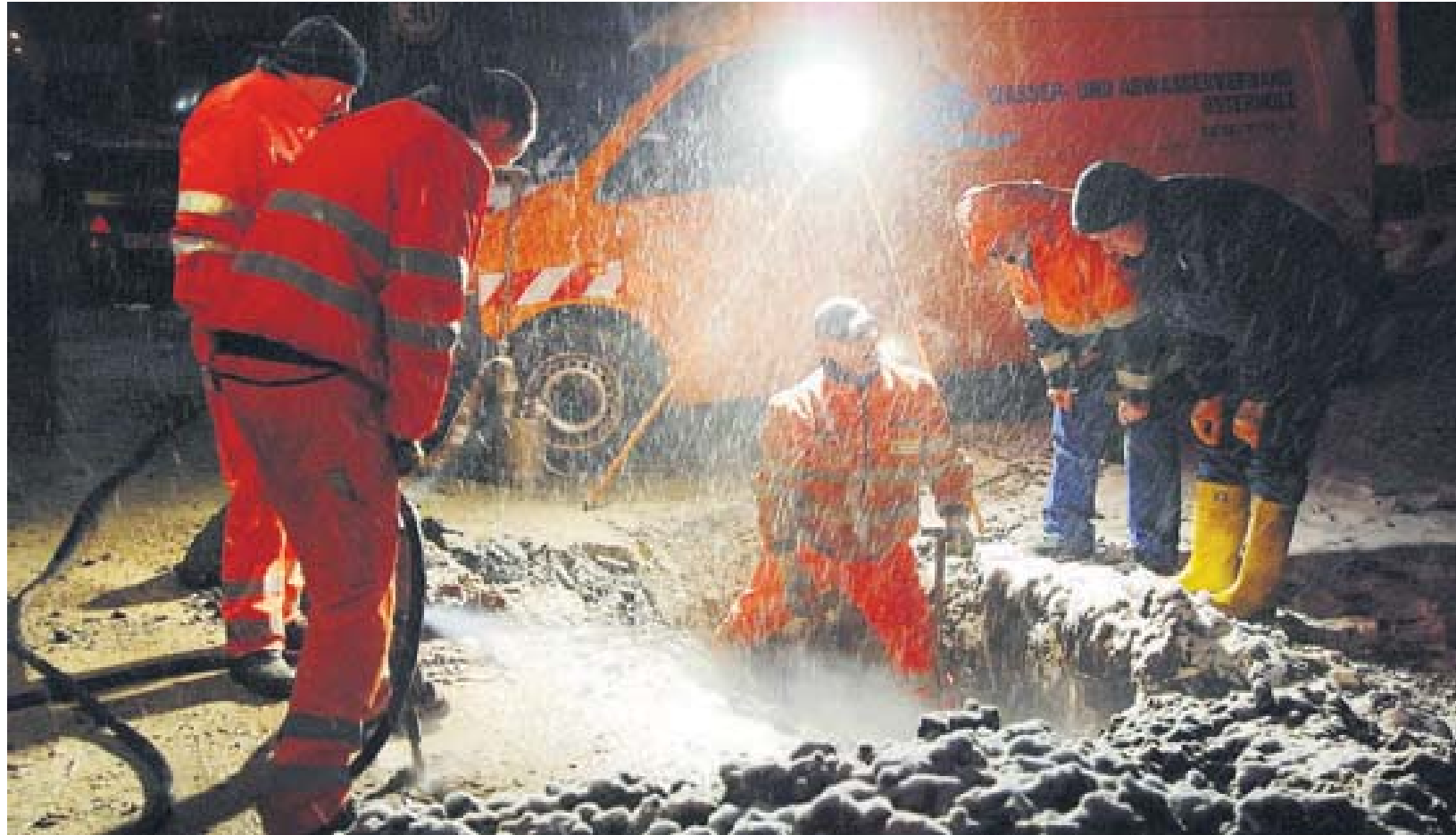
Einen Wasserrohrbruch im Schneegestöber reparieren: Das passiert nicht alle Tage. Der Einsatztrupp des Wasser- und Bodenverbandes hatte am Wullbrandt alle Hände voll zu tun. Zuvor musste eine 20 000 Watt Stromleitung, die im Weg lag, abgeschaltet werden. CVA-FOTO: CHRISTIAN VALEK
