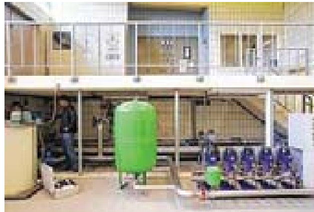
Saubere Lösung: Mit diesen fünf blauen Pumpen in der Druckerhöhungsstation, die zum Teil im Innern des Weyerbergs liegt, kommt der Wasser- und Abwasserverband aus.
