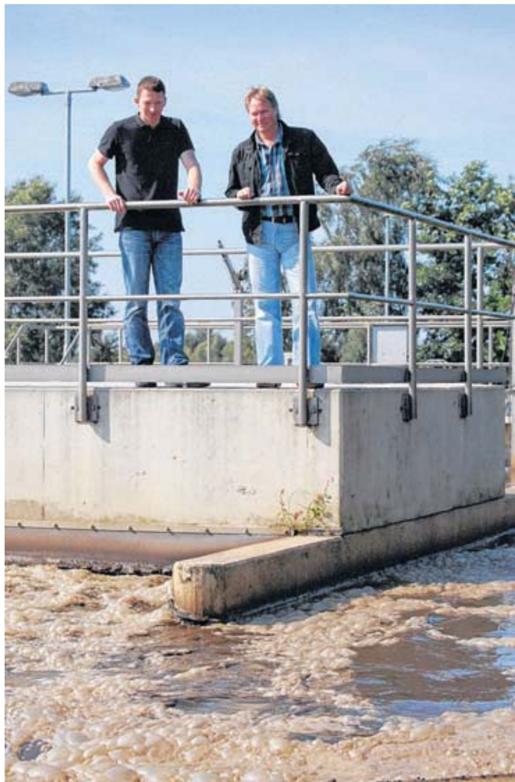
Torsten Schröder und Stefan Giese (von links) behalten die Brühe in den Belebungsbecken stets im Auge. Denn ihre Mitarbeiter, die Bakterien, verlangen genaue Arbeitsbedingungen. FOTO: LANGE
