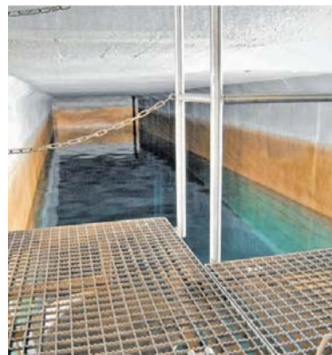
In bestehenden Behältern lagern in Wallhöfen bereits etwa 1500 Kubikmeter Trinkwasser.
