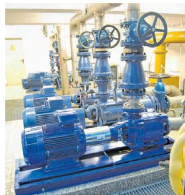
Stattliche Pumpen drücken das Wasser in die Rohre zu den Kunden.
