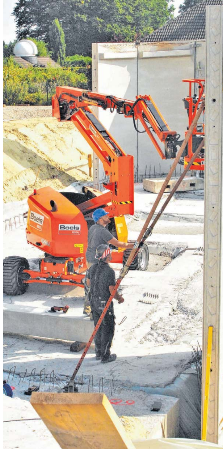
Polier Markus Bierbach bringt die Wandelemente mit Stützen ins Lot (links). Der WAV Osterholz investiert etwa 1,3 Millionen Euro in die neue, rund 1500 Kubikmeter Trinkwasser fassende Anlage in Wallhöfen. FOTOS: CHRISTIAN VALEK
